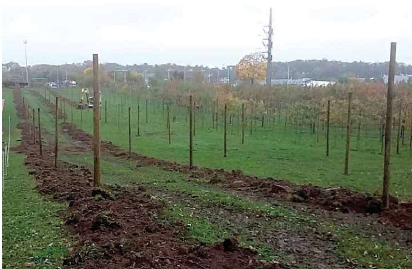
Installation des structures en vue de la réorganisation de la parcelle de pommiers
